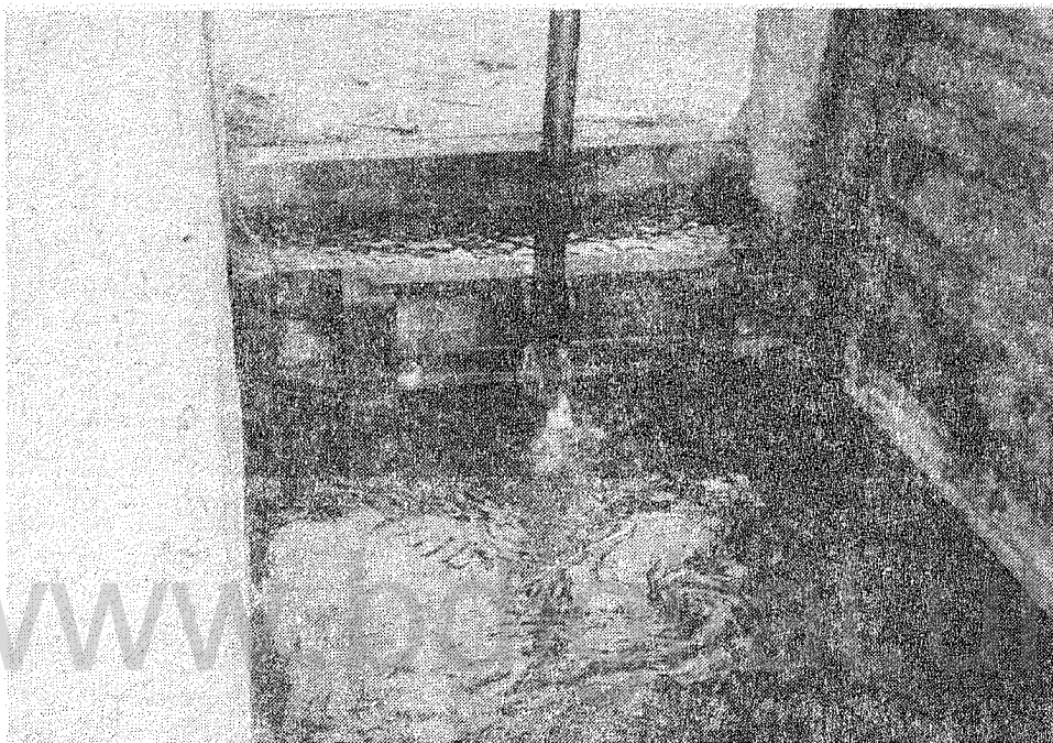
Figura 5 Compuerta de regulación, la cual alimenta al canal principal.
