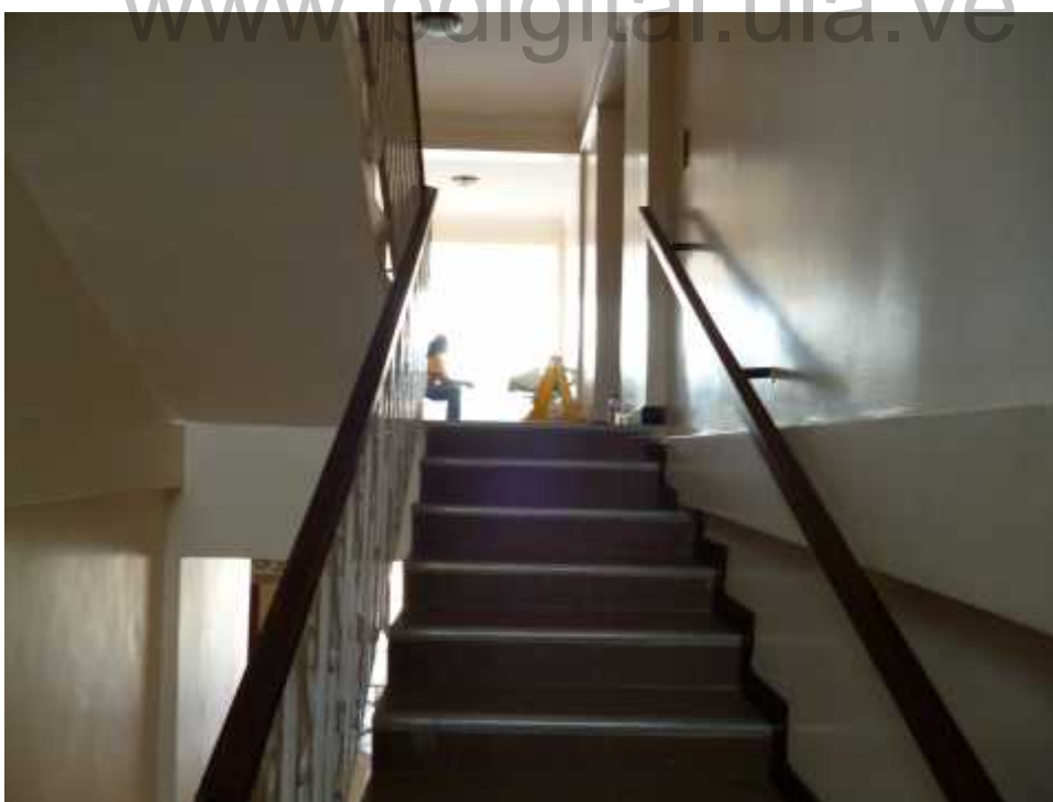
ESCALERAS Y PASILLOS QUE NO CUMPLEN CON SEÑALETICA Y NO TIENEN ANTIRESBALANTE
