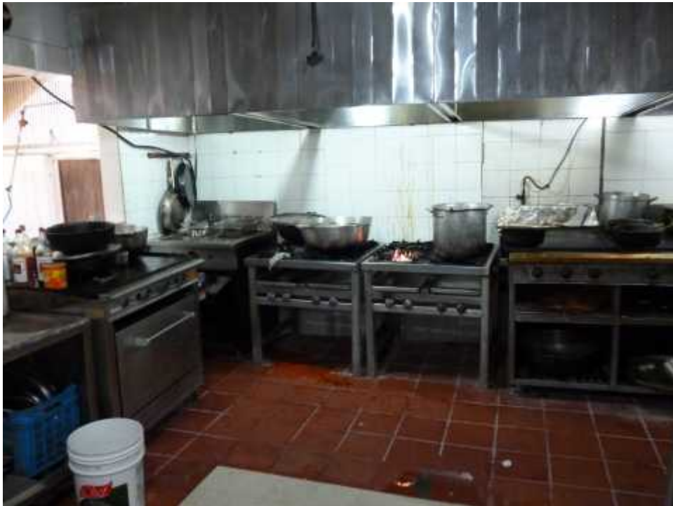
ÁREA DE COCINA SIN SEÑALETICA DE RIESGOS Y VARIOS CABLES QUE PUEDEN OCASIONAR UN ACCIDENTE
