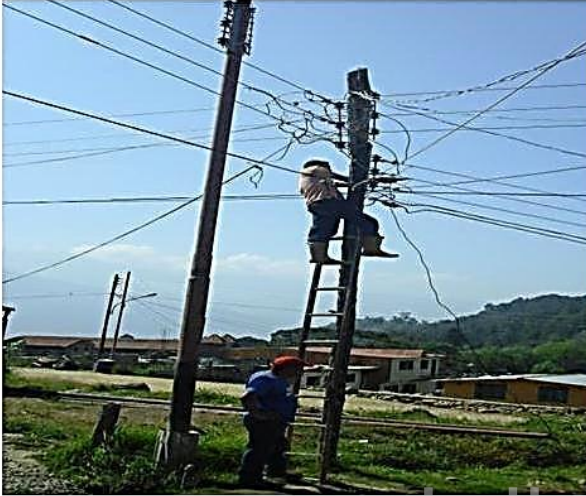
a) Red eléctrica de la calera sin facturación
