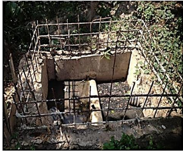
d) Vista de la red conexión de cloacas del asentamiento La Calera, descarga al Río Milla.
