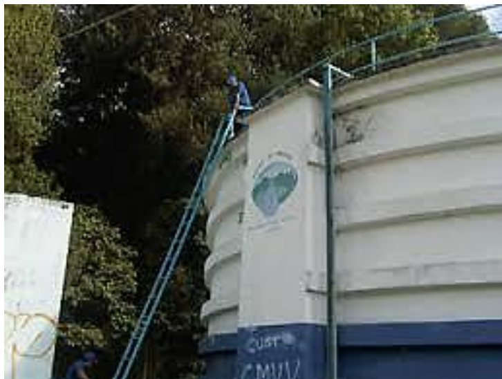
Fotografía 14 Tanque de Agua Sector San Pedro de Aguas de Mérida C.A.
