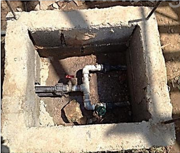
c) Conexión de red de agua potable hecha por los habitantes del sector conectada con la red de Aguas de Mérida, sin facturación.
