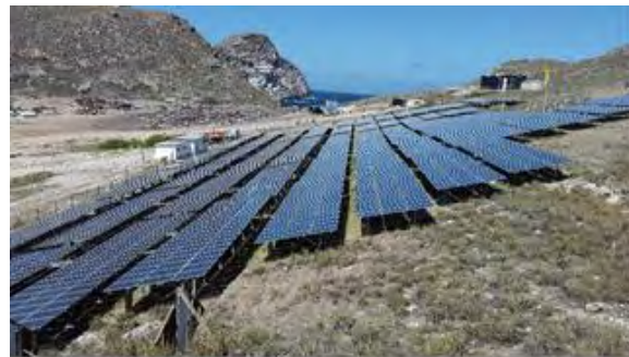
Fig. 1. Planta fotovoltaica de gran escala en el Gran Roque, Venezuela.
