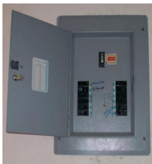
Figura 4.20. Tablero Oficinas PDVAL.
