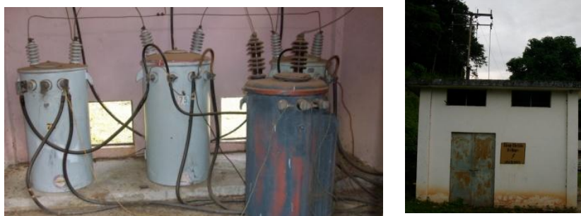
Figura N°4.4. Caseta de transformación.
