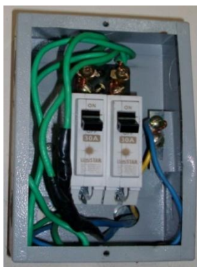
Figura 4.25. Tablero Taller La CIMBALI.
