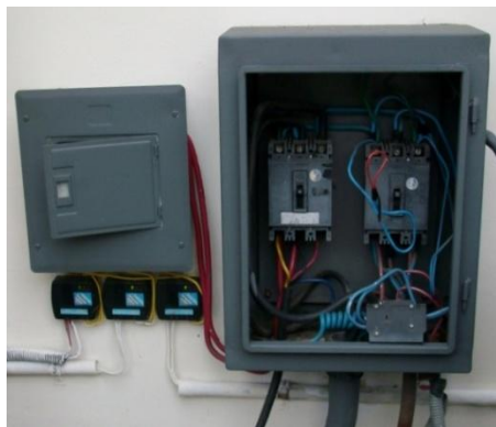
Figura 4.14. Tablero Aire Acondicionado Oficinas.
