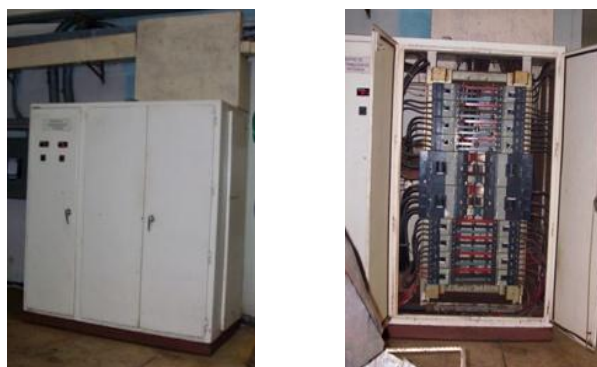
Figura 4.7. Centro de Distribución Principal.
