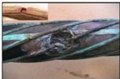
a. Daños por corrosión
